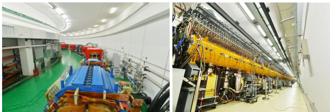
图3 散裂中子源隧道中完成安装的磁铁和DTL
